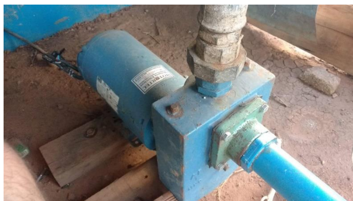
Figura 5: Conjunto Motobomba instalado na propriedade.
