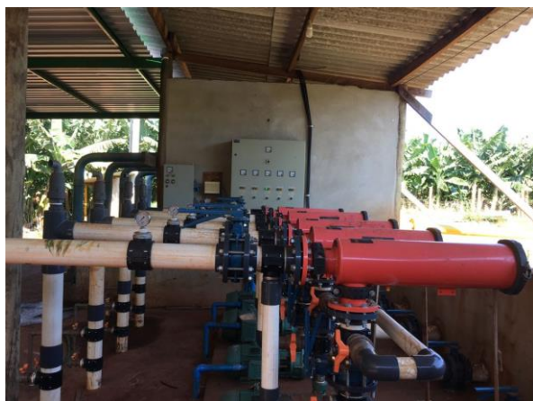
Figura 4 – Válvulas de retro-lavagem dos filtros.
