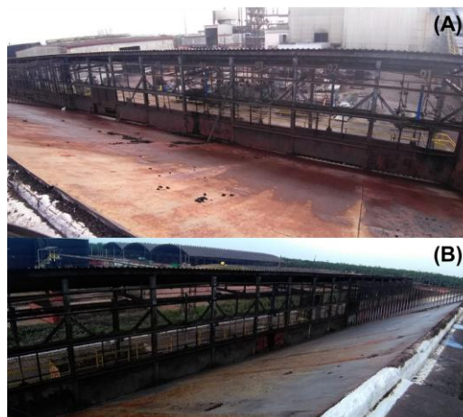
Figura 4: Área de descarregamento da moega longitudinal (A) e transversal (B).
