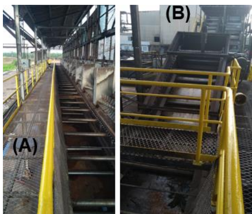
Figura 8: (A) - Transportador da moega transversal. (B) Encontro dos transportadores, que seguem para a parte interna da usina.
