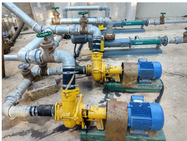
Figura 3 – Conjunto de bombas dos sistemas de recirculação e fertirrigação.
